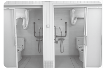
シャワー設備
